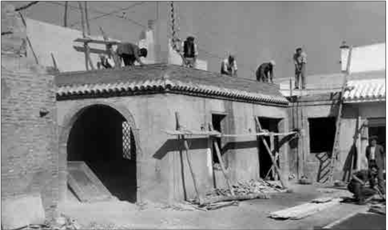
Obras de construcción del mercado de abastos (antiguo cuartelillo de la policía municipal) hacia 1952. Se inauguró el 22 de enero de 1953.
