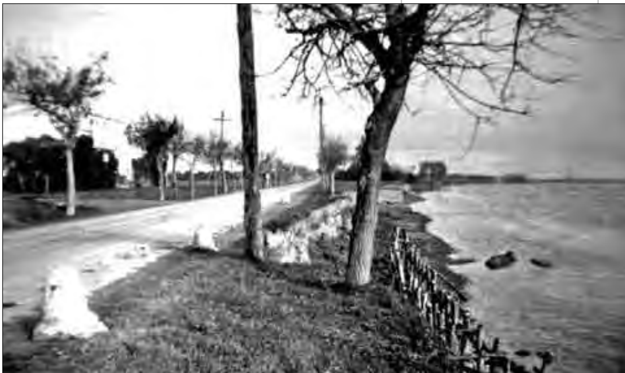
Carretera de Coria a Sevilla en 1958. La erosión producida por el río amenaza la carretera.
