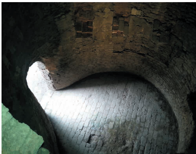
FOTO 4: Vista interior de la caldera y cámara de combustión de un antiguo horno alfarero de Triana. Se puede ver el arranque de los arcos que conformaban la parrilla, desaparecida por hundimiento de la misma.
